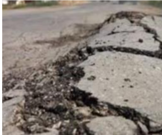
照片 3-1 道路冻胀裂缝
